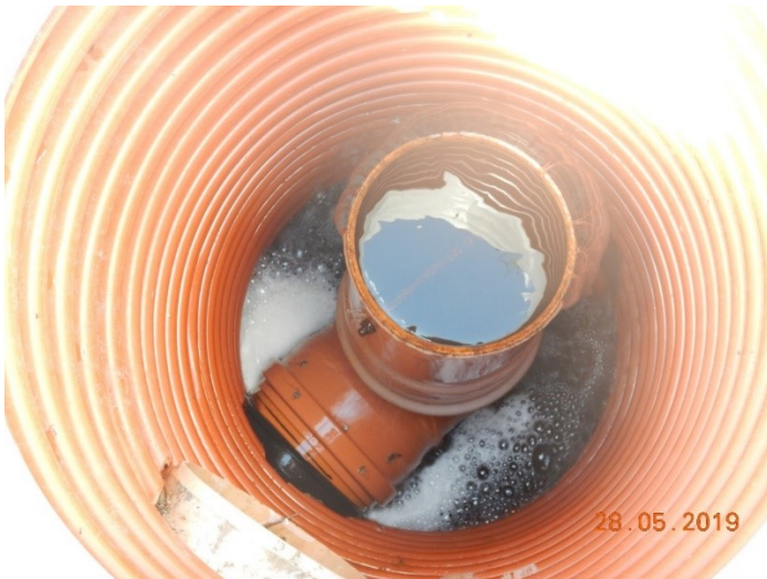
Figur 7.31 Iltningsbrønd som i Figur 7.29
