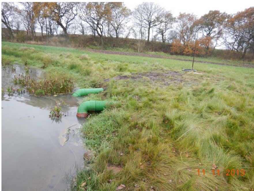
Figur 4.10 Udløbsrør. Her føres vandet fra sidste dybe zone videre til iltningstrappen.
