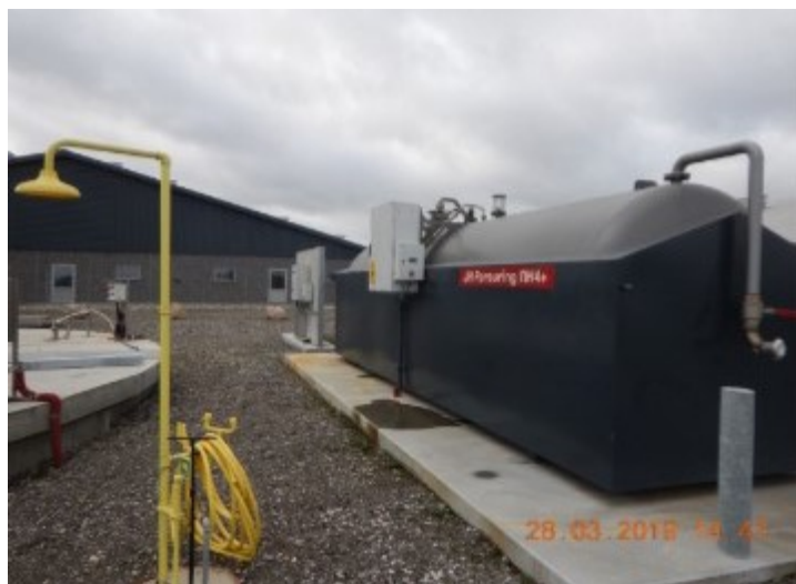
Gylleforsuringsanlæg på støbt fundament med sikkerhedspullerter, nødbruiser og tankvognsstuds yderst til højre.
